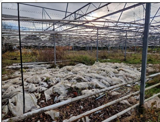
Fig. 2.6, Zuidelijk deel van kassen, reeds vervallen (bron: FF Solutions)
